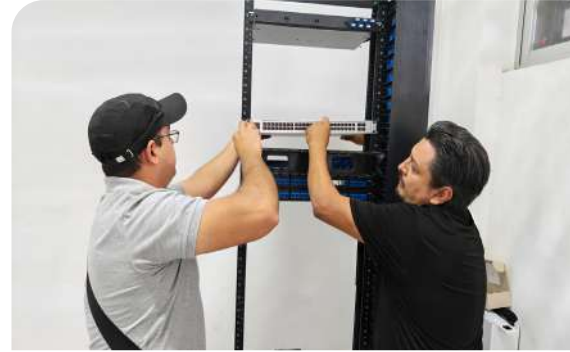
Instalación de switch
